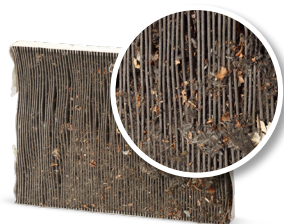
Bez konserwacji klimatyzacji
