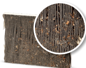
Sin mantenimiento del sistema de A/A
